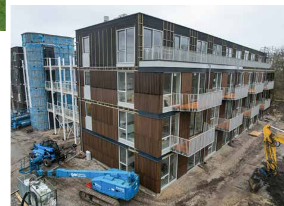
Warmtepompen en PV-panelen zorgen ervoor dat het gebouw zo duurzaam mogelijk is.
